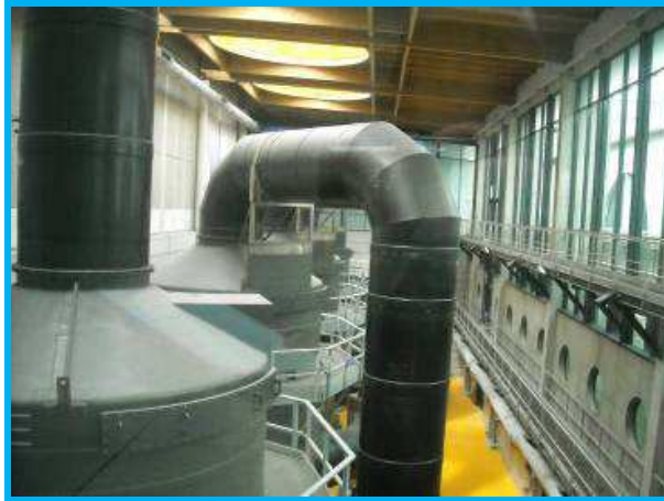
Figure 232 : Photo sur site des tours de désodorisation
