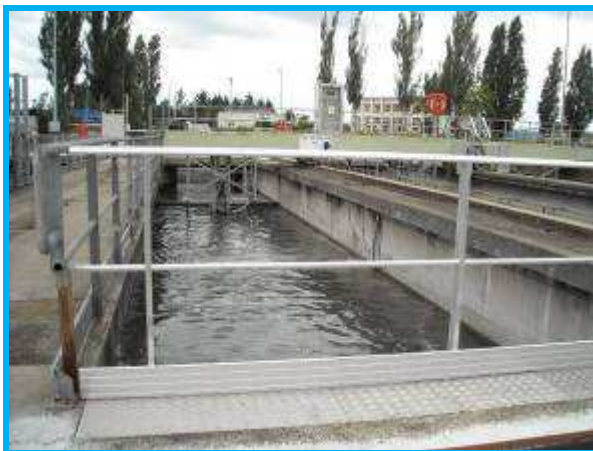
Bassin de dessablage-dégraissage plein
