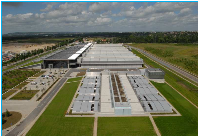
Figure 233 : Vue aérienne des installations de nitrification et post-dénitrification (post-dénitrification au premier plan, nitrification au deuxième)
