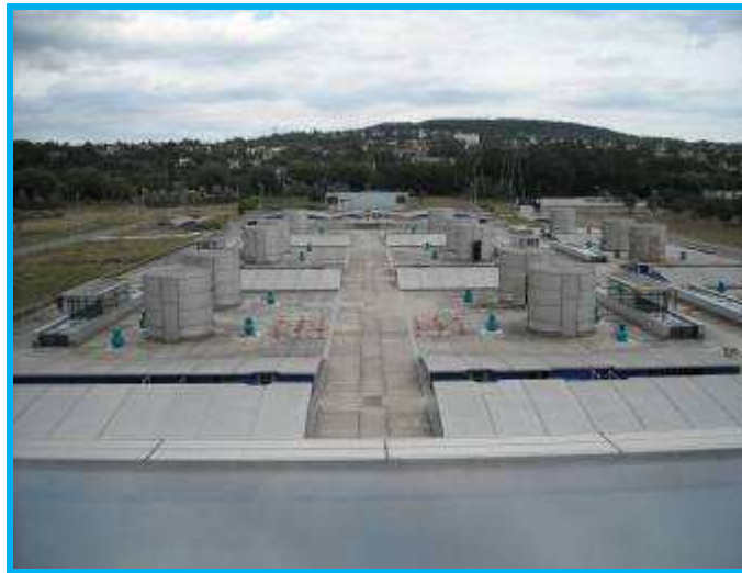
Figure 231 : Photo sur site des Actiflo et des épaisseurs (arrière-plan)
