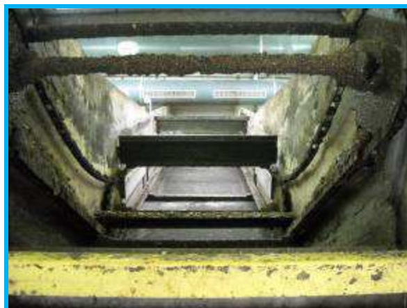
Figure 224 : Photo sur site de l'écrémage des graisses
