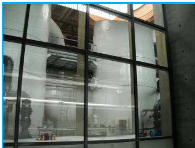
Figure 235 : Photo sur site de l'installation de désodorisation de la nitrification
