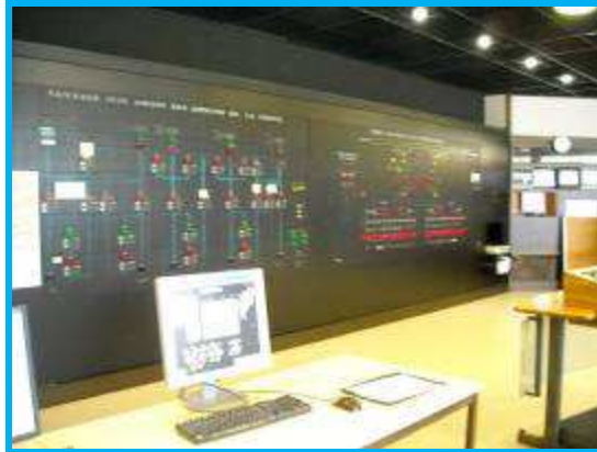
Figure 244 : Photo sur site du poste de commande
