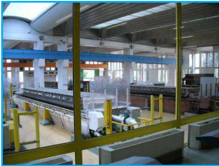
Figure 241 : Photo sur site des filtres-presses de la déshydratation des boues
